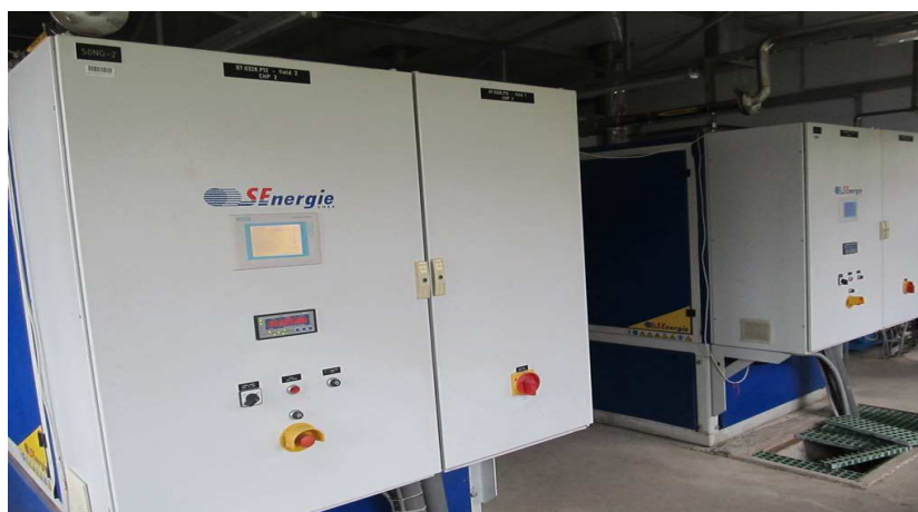
Slika 1. Gasni generatori na subotičkom postrojenju za prečišćavanje otpadnih voda
